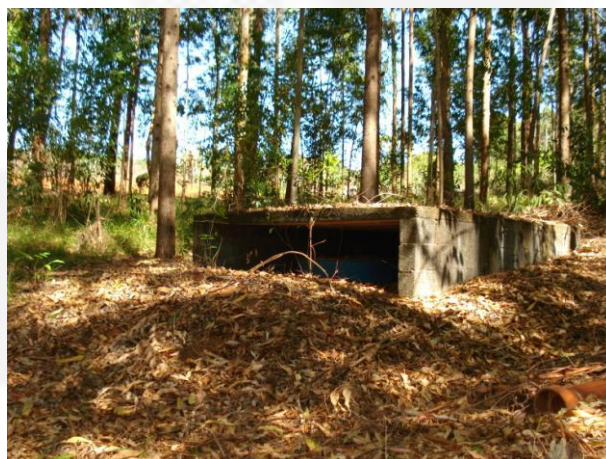
Foto 04. Fossa séptica e sumidouro.
