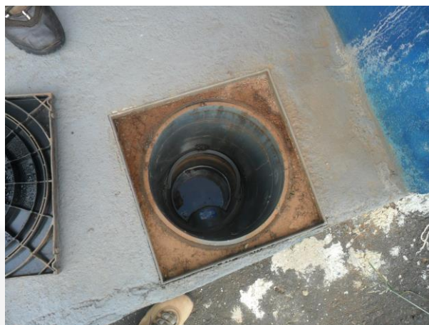
Foto 06. Sistema de gradeamento para efluentes industriais.
