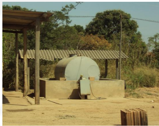
Foto 14: Posto de abastecimento – Tanque 2.
