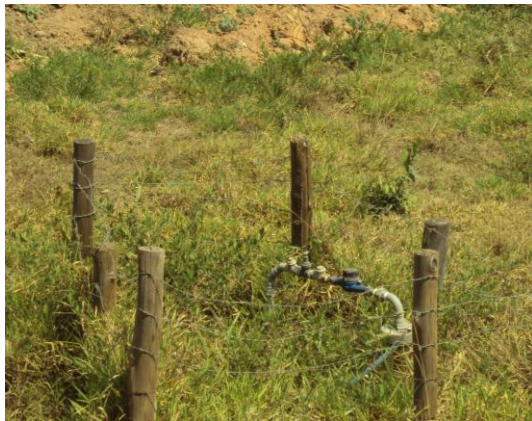
Foto 17: Poço tubular com horímetro e hidrômetro.
