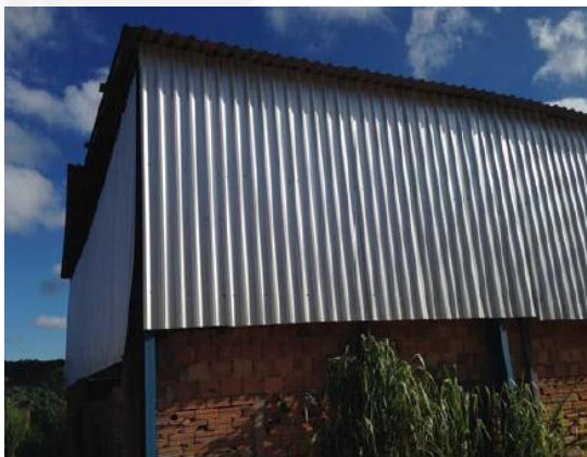
Foto 3: Depósito de pó de balão – vista lateral externa.
