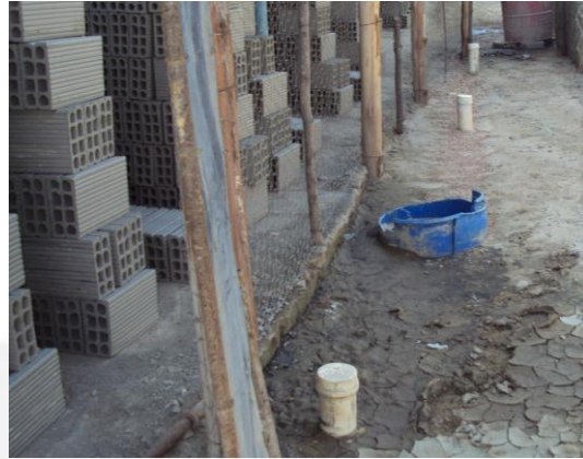
Foto 12: Fossa séptica, filtro e sumidouro.
