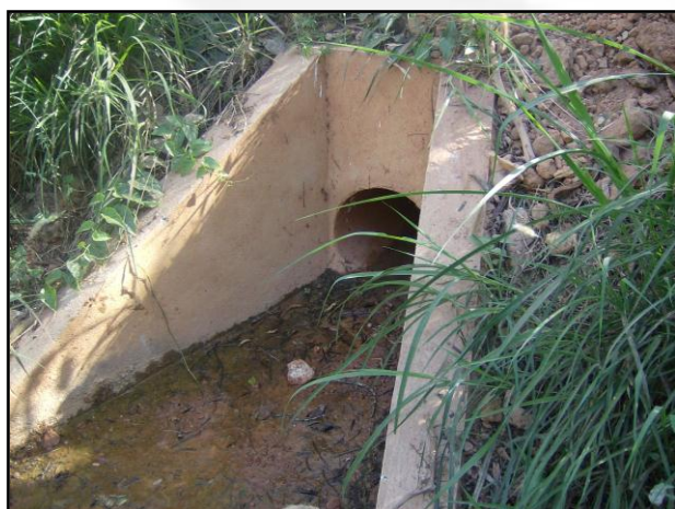
Foto 05: Emissário de lançamento do efluente tratado.
