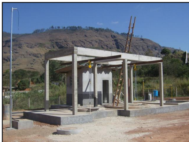
Foto 01: Estação Elevatória na área da ETE.
