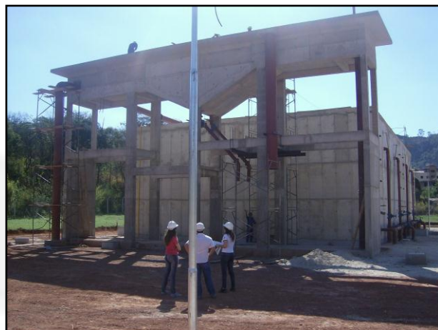
Foto 02: Vista do Sistema de Tratamento Preliminar.
