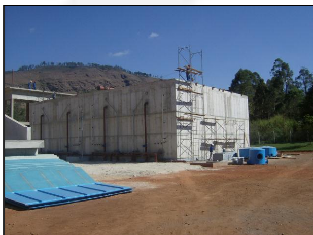
Foto 03: Vista dos dois Reatores UASB.
