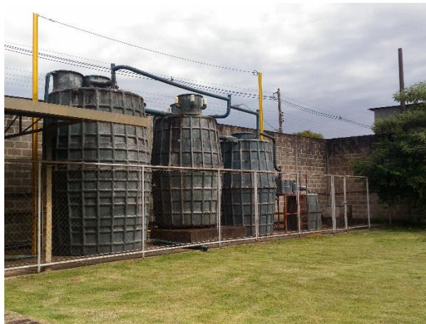
FOTO 1 - Estação de tratamento de efluentes – ETE.
