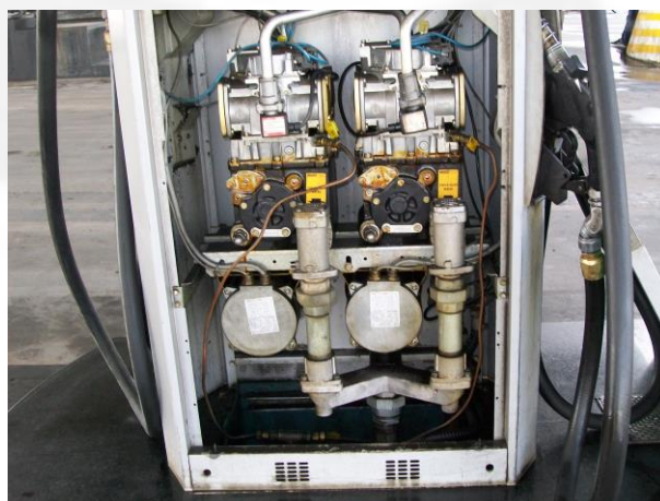
Imagem 03: SUMP e Check Valve das bombas de abastecimento.
