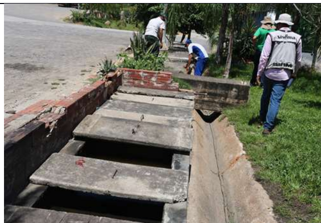
Caixa Separadora de Água da pista de abastecimento.
