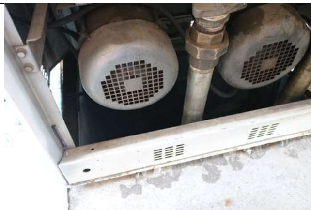
Bombas de abastecimento com SUMP e chekvalve
