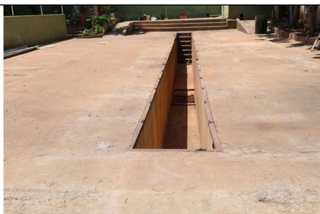
Área de lavagem de veículos desativada
