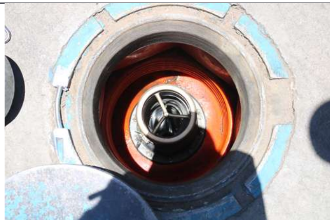
SUMP da área de descarga com cruzeta.
