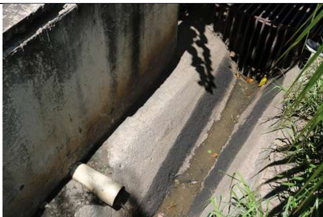
Efluente da caixa SAO da pista de abastecimento sendo lançado em sarjeta próximo a BR 251.
