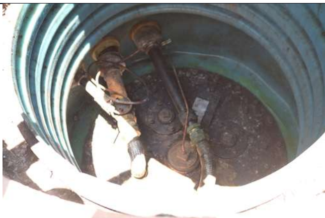
SUMP do tanque sem o monitoramento intersticial
