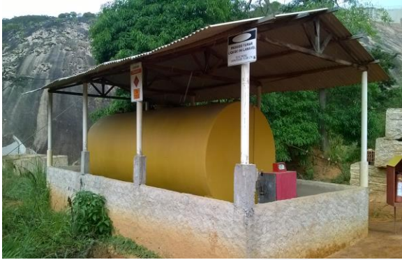
Foto 7. Tanque de abastecimento.
