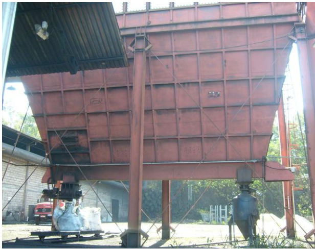
Foto 03. Filtro de mangas da descarga de carvão
