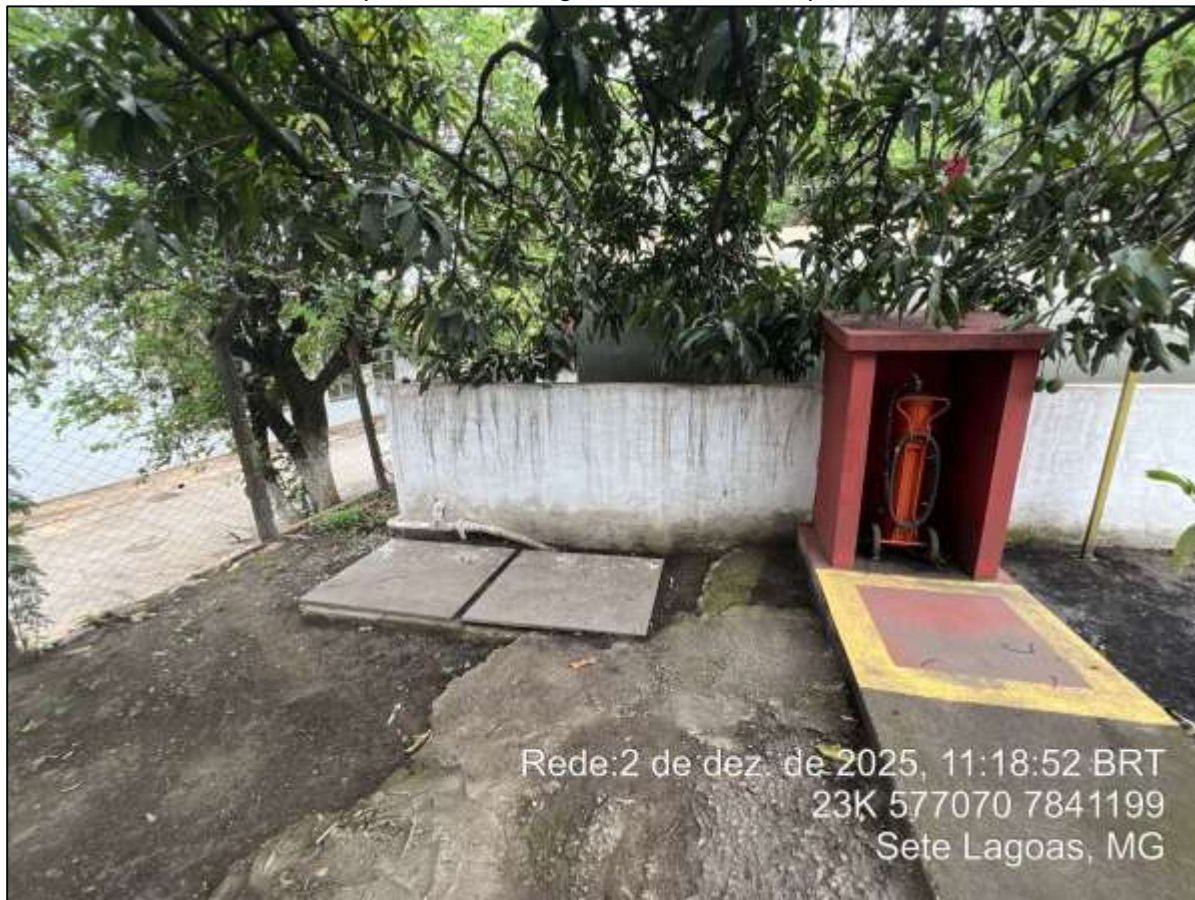
Foto 32: Caixa Separadora de Água e Óleo do tanque de combustível.
