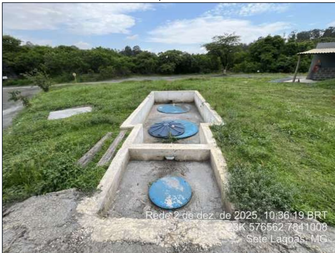
Foto 16: Fossa séptica da área da UTM.
