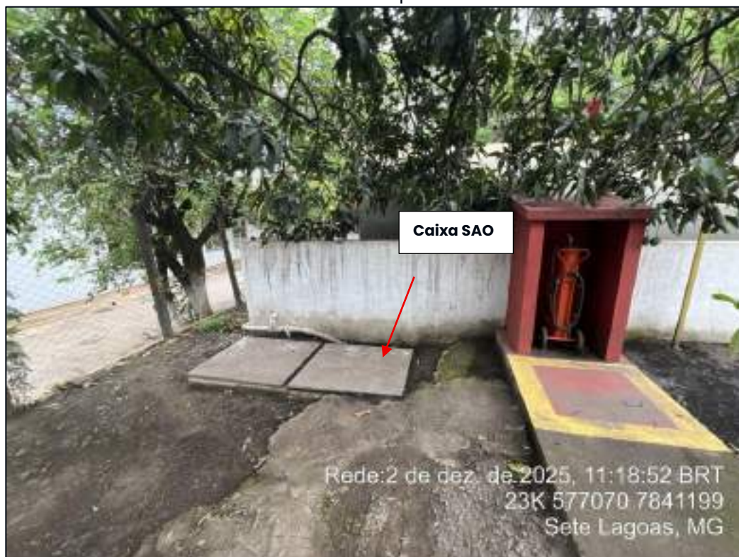
Foto 9: Caixa SAO – tanque de combustível.
