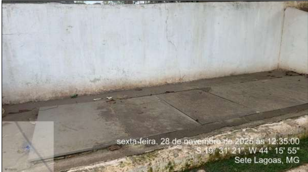
Foto 2: Fossa séptica – Administrativo.
