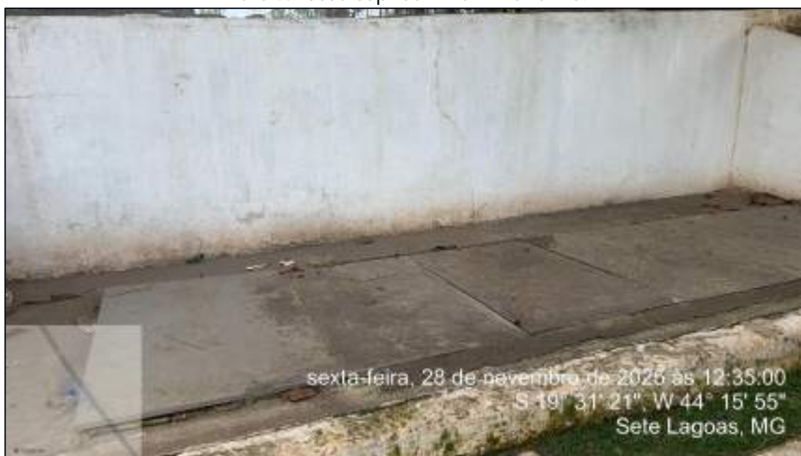
Foto 6: Fossa séptica – Administrativo.
