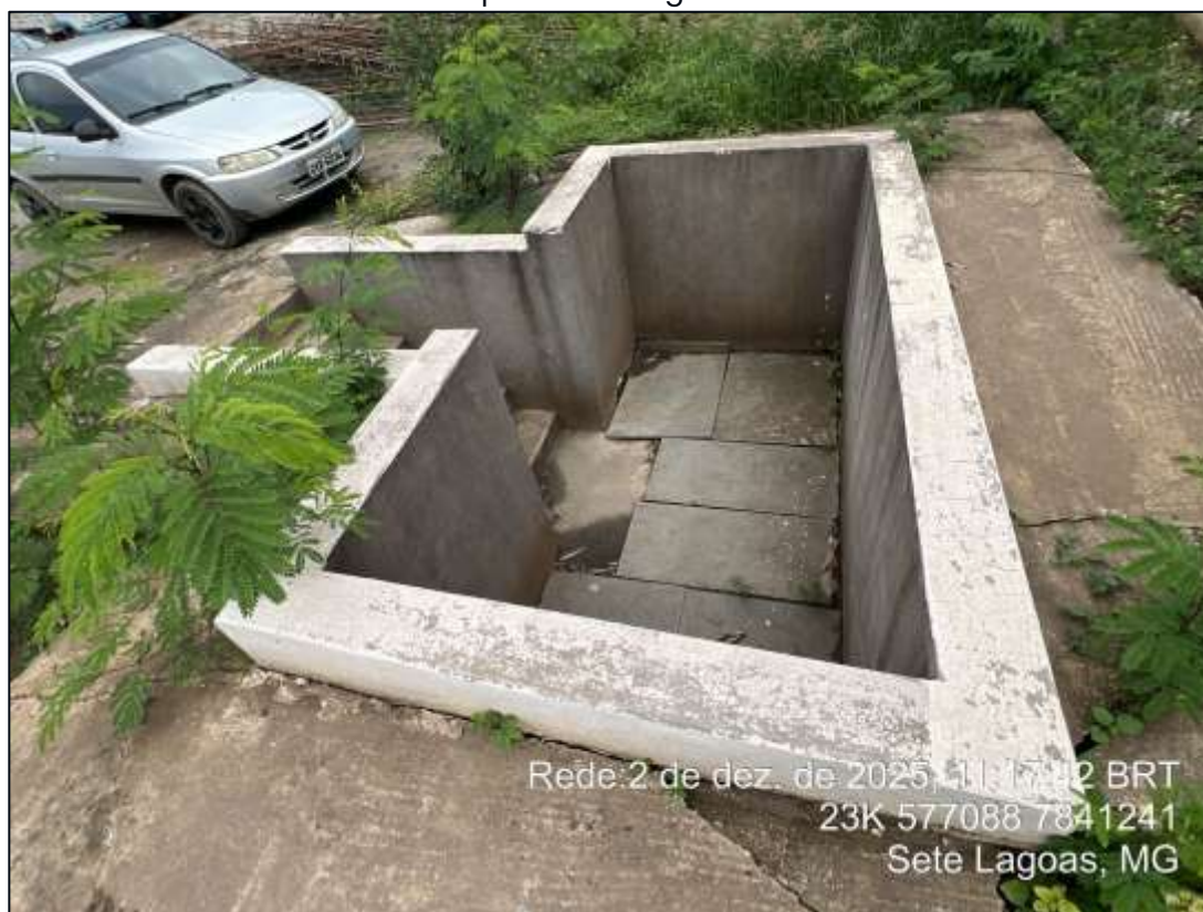
Foto 29: Caixa separadora de água e óleo do lavador.
