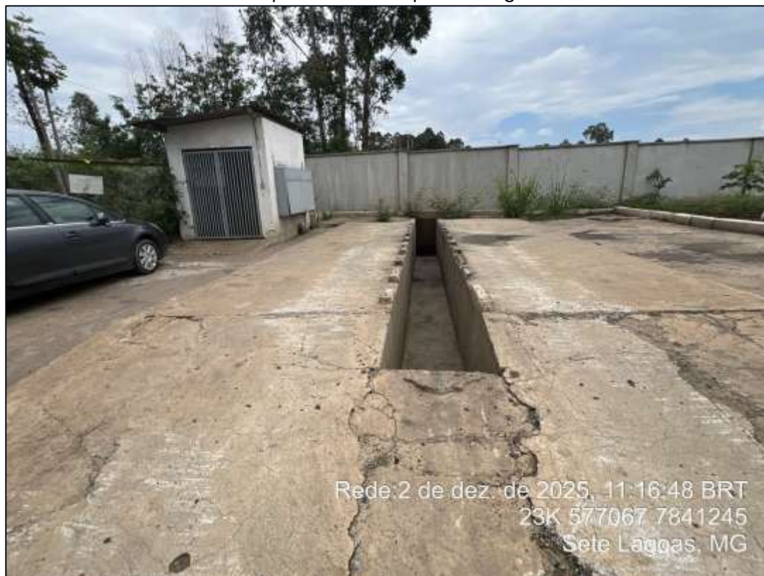
Foto 28: Local impermeabilizado para lavagem de veículos.
