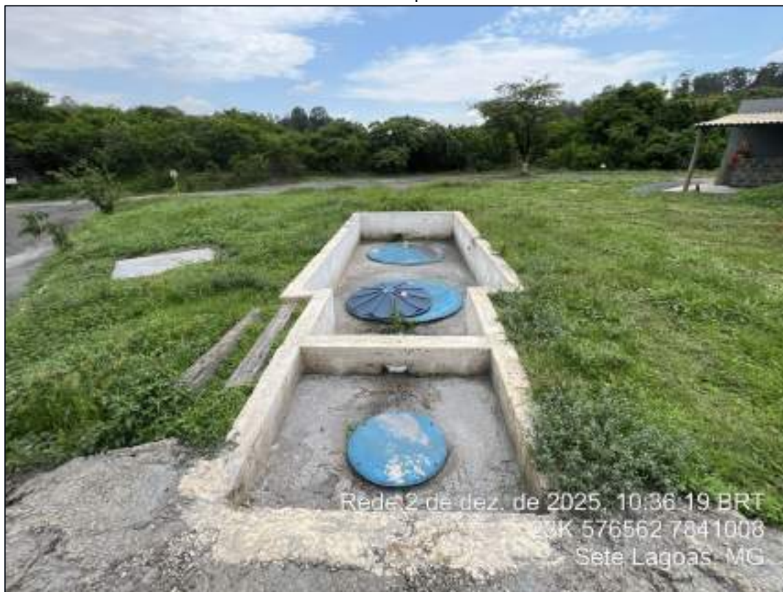
Foto 5: Fossa séptica – UTM.
