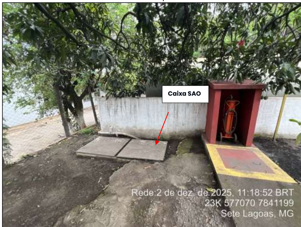
Foto 5: Caixa SAO – tanque de combustível.
