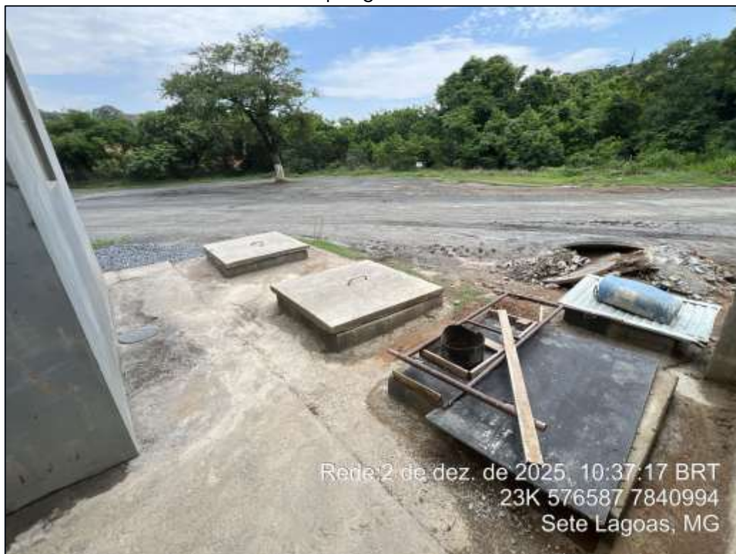
Foto 14: Caixa Separadora de Água e Óleo da área de manutenção e abrigo de resíduos perigosos.
