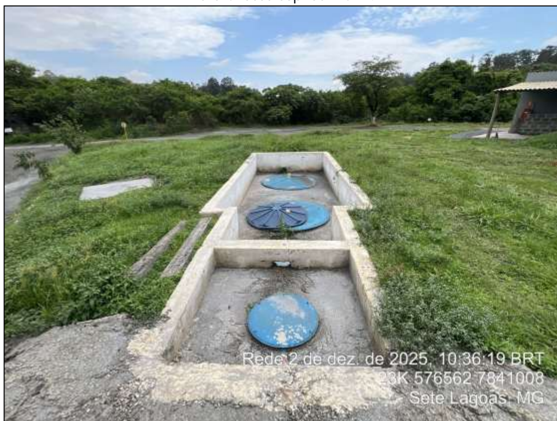
Foto 1: Fossa séptica – UTM.
