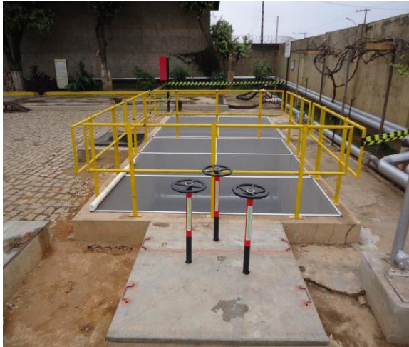
Foto 01. Caixa Separadora Água e Óleo
