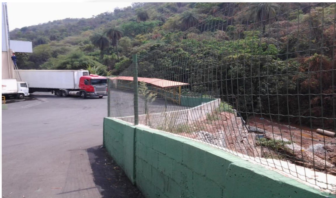
Figura 2: Vista da ocupação em APP com muro gabião parte direita inferior
