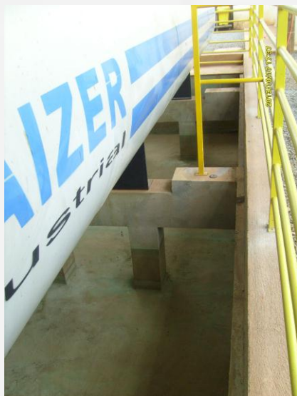
Foto 7: Bacia de contenção da autoclave.
