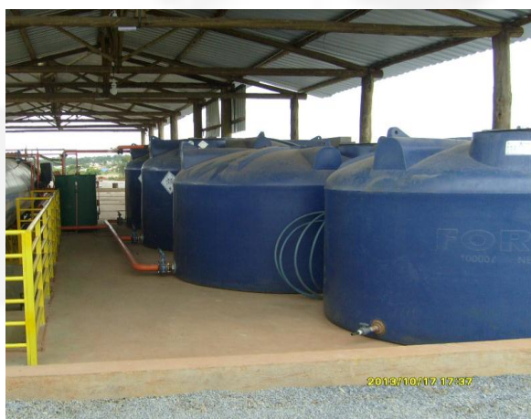
Foto 4: Tanques de estocagem de água e de CCA.
