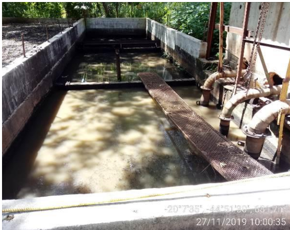
Foto 07. Tanque recirculação de água
