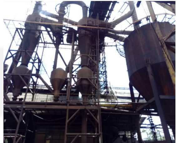
Foto 02. Sistema de limpeza de gás
