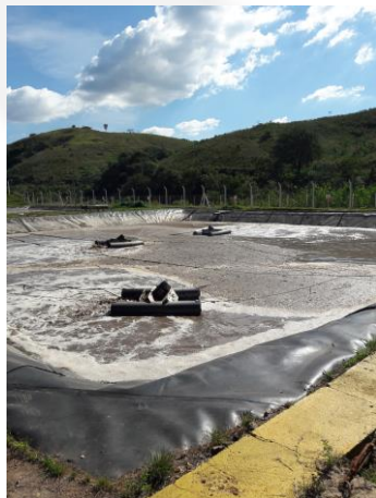
Foto 03. Lagoa de tratamento
