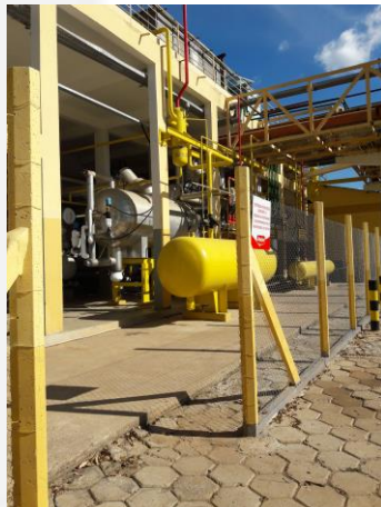
Foto 07. Setor de máquinas
