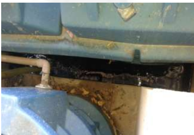
Foto 15. Caixa Separadora Água-Óleo com grande quantidade de óleo derramado em seu entorno (20/07/2015).
