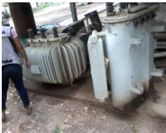
Foto 2. Óleo extrapolarando o limite da área impermeabilizada da oficina de veículos e máquinas (26/01/2015).
