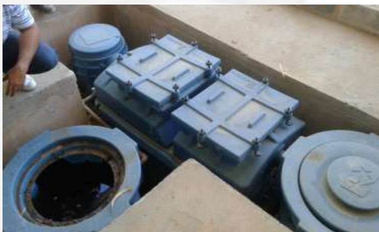
Foto 14. Vista da nova Caixa Separadora Água-Óleo (20/07/2015).
