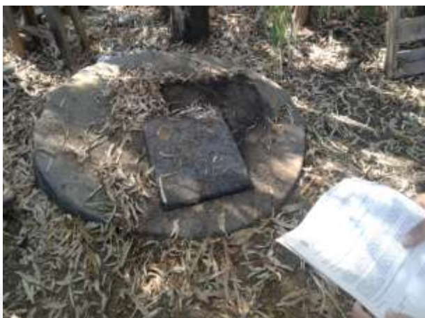
Foto 13. Fossa negra que recebe efluente sanitário do escritório (20/07/2015).
