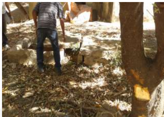
Foto 12. Caixa séptica que recebe efluente sanitário do vestiário (20/07/2015).
