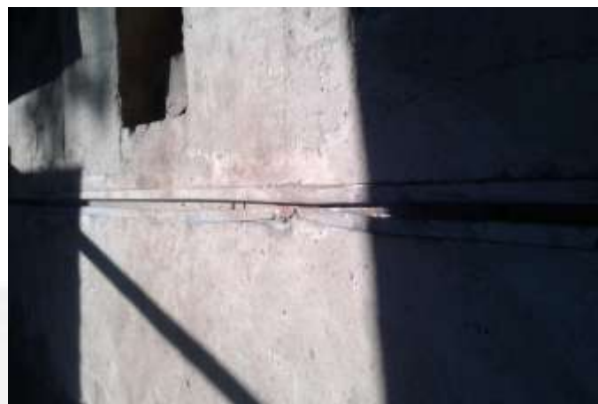
Foto 3. Canaleta obstruída na oficina de veículos e máquinas (20/07/2015).
