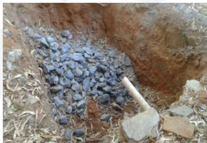
Foto 16. Sumidouro da Caixa Separadora Água-Óleo. (20/07/2015).
