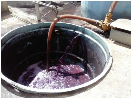
Foto 3: Estação de tratamento de efluentes industriais.
