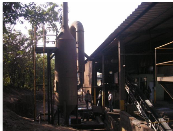
Foto 02. Vista do galpão de produção e do sistema de lavagem de gases.
