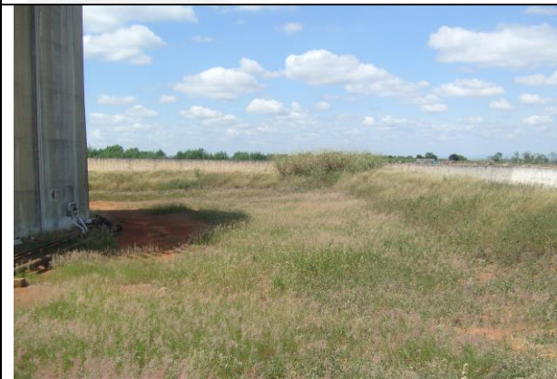
Foto 3: Bacia de contenção.
