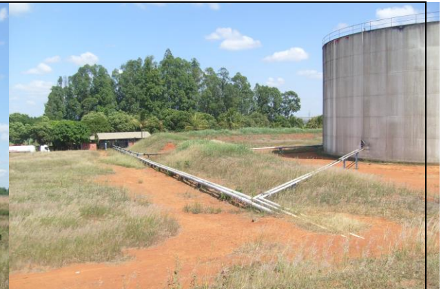
Foto 2: Tubulação do tanque que será futuramente instalada (foto da estrutura presente na Agropéu).
