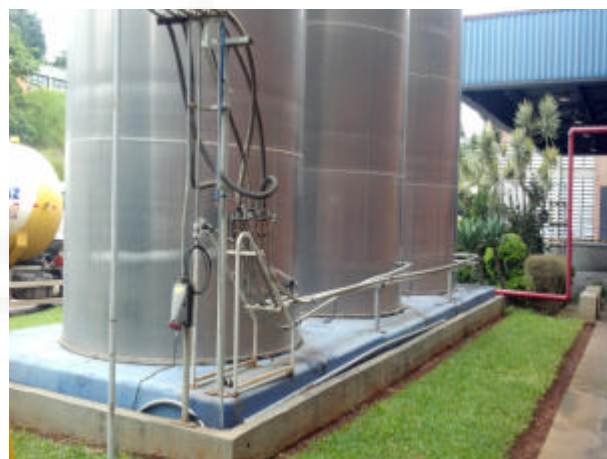
Foto 02. Silos de armazenamento de matéria-prima
