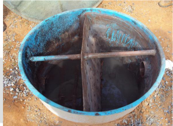
- Caixa receptora do efluente líquido.
