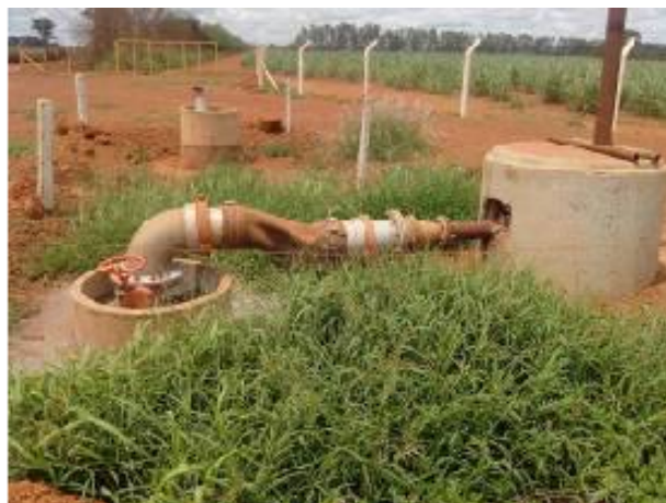
Foto 03. Tubulação de vinhaça
