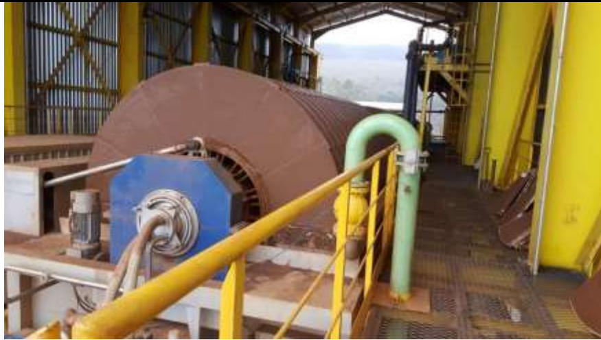
Figura 15 Filtro cerâmico para secagem do rejeito em operação no empreendimento
