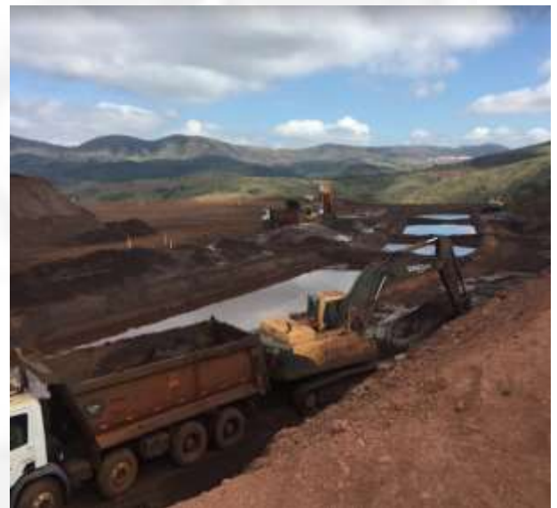
Figura 7 Baias de decantação em operação
