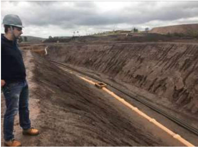
Figura 8 Sistema de controle de drenagem para isolar a Barragem B 1
