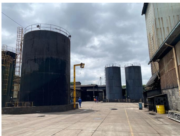
Foto 11. Tanques de armazenamento de solução - Fermavi I
