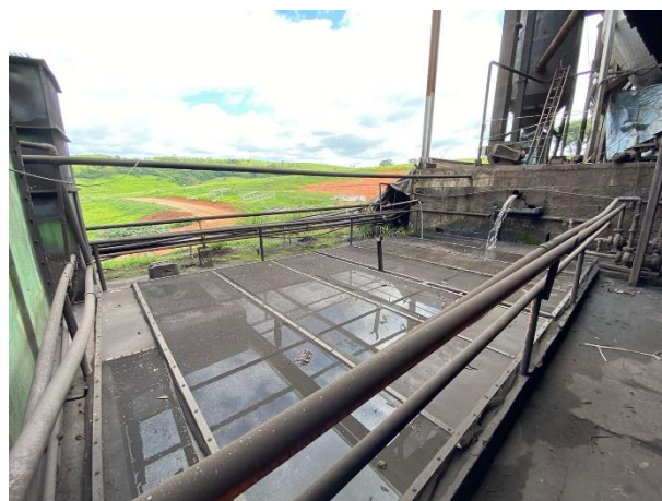
Foto 12. Tanque de água do sistema de produção - Fermavi I
