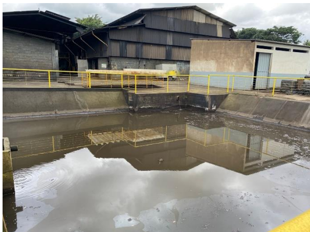
Foto 13. Tanque de armazenamento de água pluvial - Fermavi I
