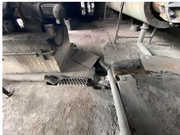
Foto 14. Sistema de drenagem - Fermavi I
