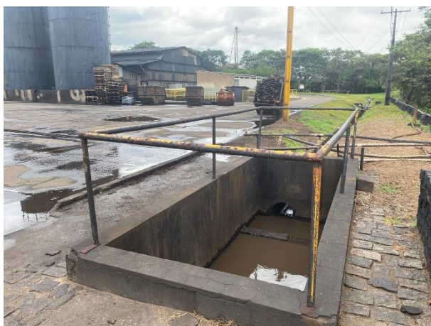
Foto 15. Sistema de drenagem - Fermavi I
