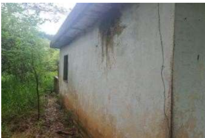
Foto 7.7.5 – Lateral da casa evidenciando rachaduras
