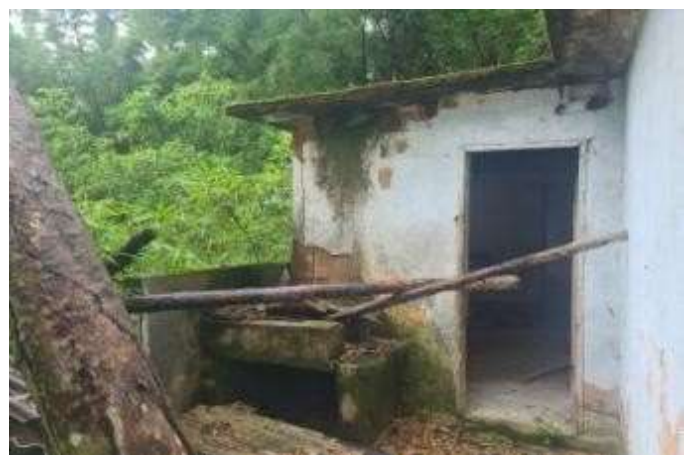
Foto 7.7.6 – Estado de abandono da edificação
