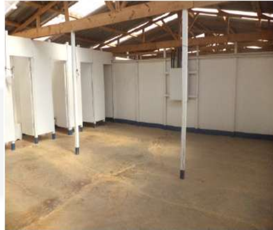
Foto 12 – Canteiro de obras – Sanitários
