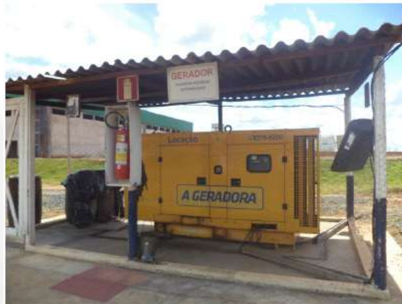
Foto 17 – Gerador utilizado na fase de implantação do empreendimento
