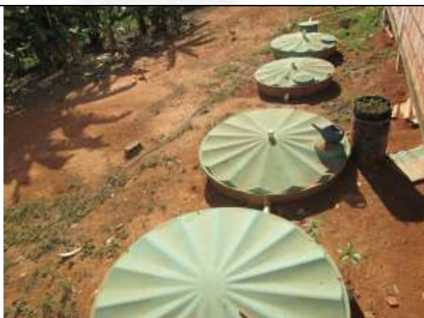
Foto 9. Fossas sépticas do empreendimento.
