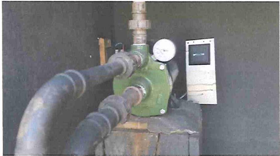
FOTO 01 – Conjunto moto bomba e horímetro instalado
