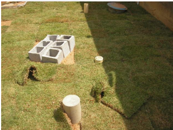
Foto 03. Fossa Séptica, com filtro anaeróbico.
