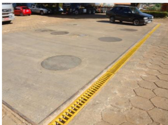
Figura 01: Área dos tanques
