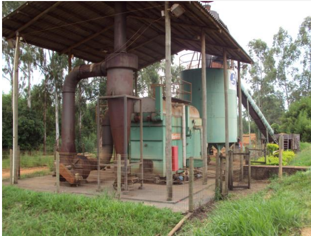
Foto 01. Gerador de água quente
