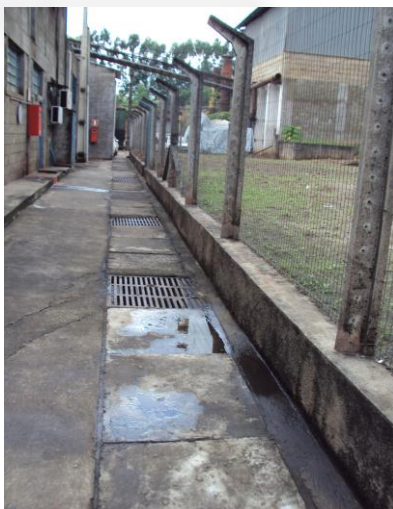
Foto 9: Sistema de drenagem pluvial.
