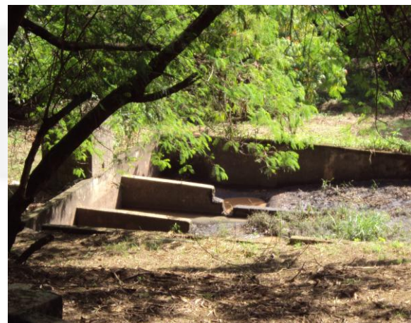
Foto 10: Cacimba do sistema de drenagem pluvial.
