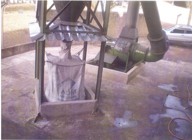
Foto 11: Exaustor e Big Bag com baias de contenção.
