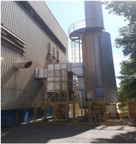
Foto 3 – Sistema multiciclone e chaminé da caldeira
