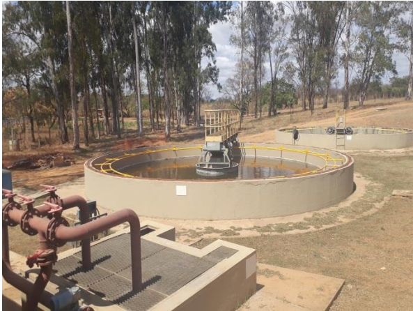
Foto 9 – Decantadores da PTAR
