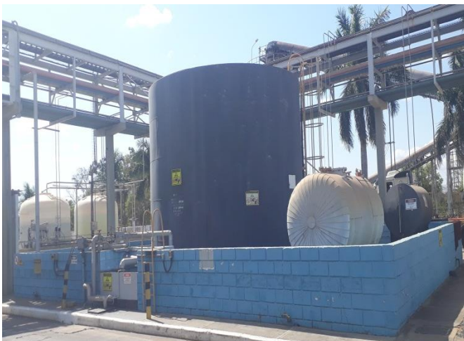
Foto 1 – Tanques de armazenamento de óleo BPF, diesel, soda e ácido
