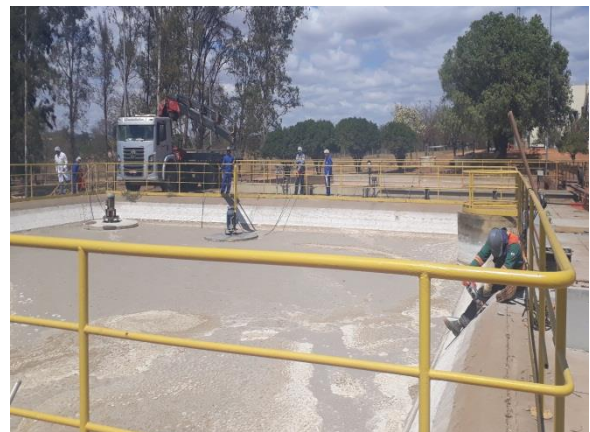
Foto 8 – Tanque de aeração da PTAR
