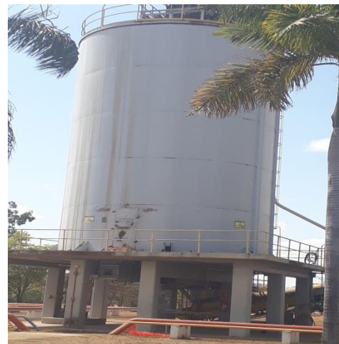
Foto 2 – Silo armazenamento cavaco para caldeira
