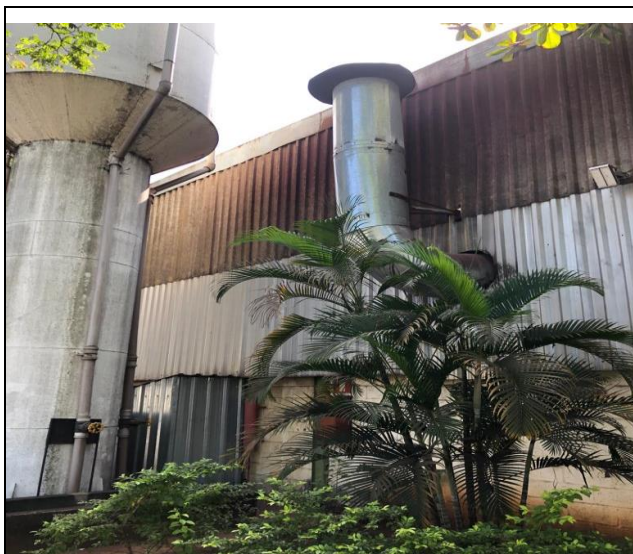
Foto 07. Chaminé de exaustão da cabine de pintura.
