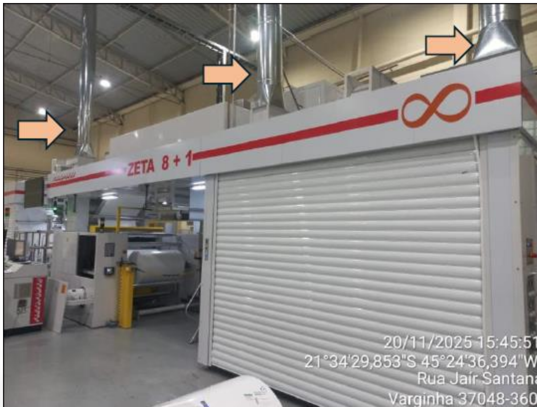
FIGURA 02 - Detalhe do sistema de exaustão instalado, com setas indicativas das tubulações em aço galvanizado para controle de emissões. Fonte: resposta à solicitação de informações complementares
