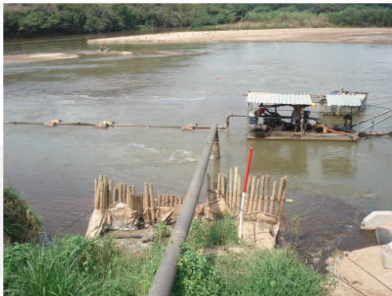
Foto 01. Local de instalação do Emissário de Efluentes Líquido da CENIBRA, com vistas do emissário antigo e respectivo vazamento do efluente e ao lado novo emissário já instalado e submerso.
