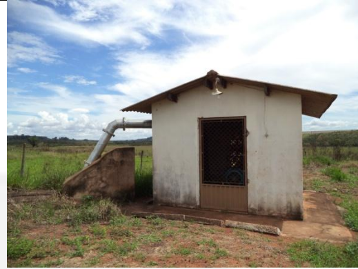
Figura 04. Casa de bombas
