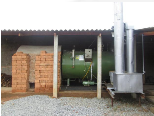
Foto 09. Caldeira com sistema de caixa de fumaça
