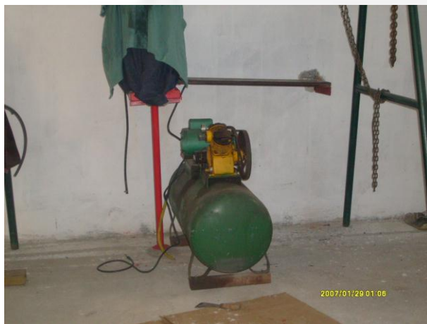
Foto 01. Compressor em local fechado e piso impermeabilizado
