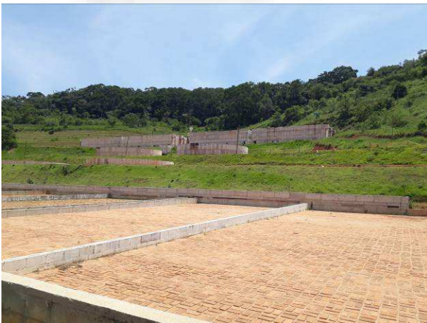
Foto 07. Leitos de secagem
