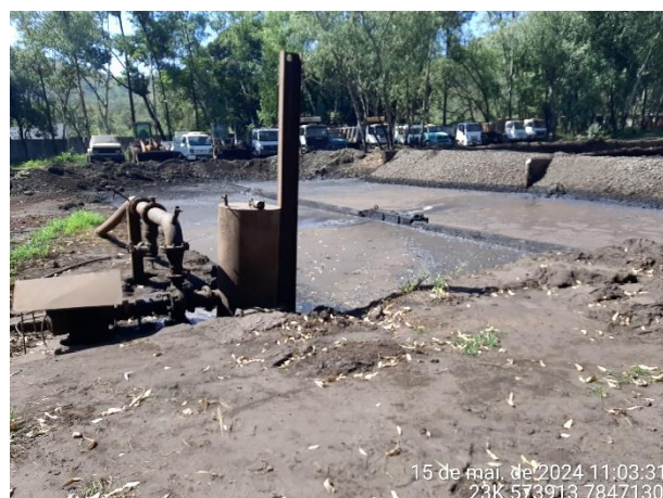
Foto 16: Bomba d'água instalada na baía para captação da água e retorno ao sistema de lavagem de gases.
