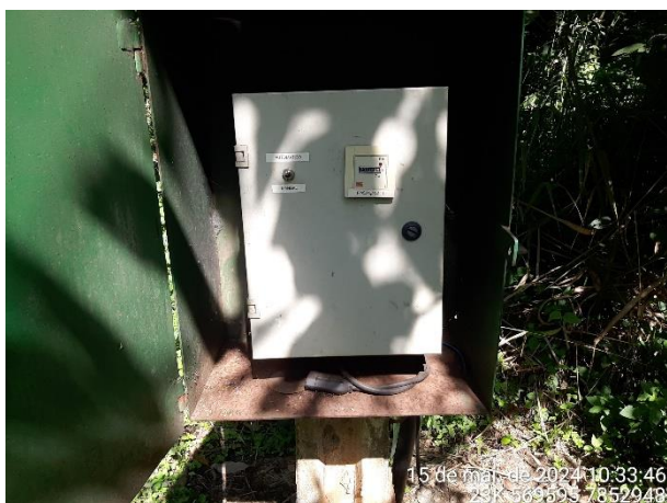
Foto 41: Horímetro do Poço 02.
