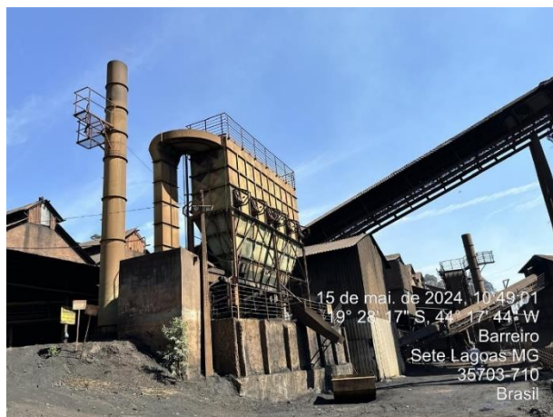
Foto 59: Filtro de mangas do alto-forno.
