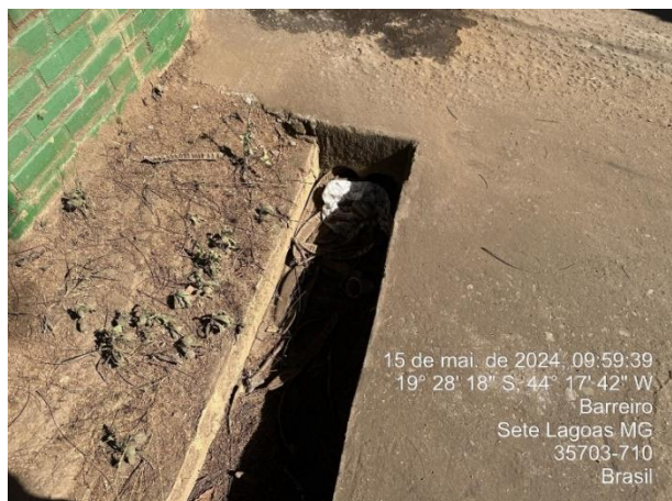
Foto 7: Canaleta de drenagem obstruída.
