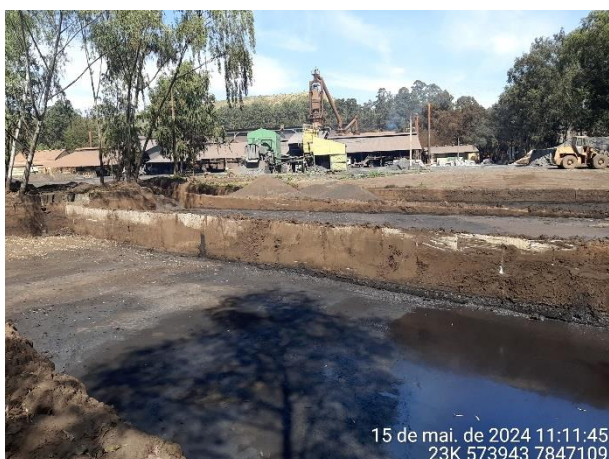
Foto 15: Baías de decantação de pó de balão.
