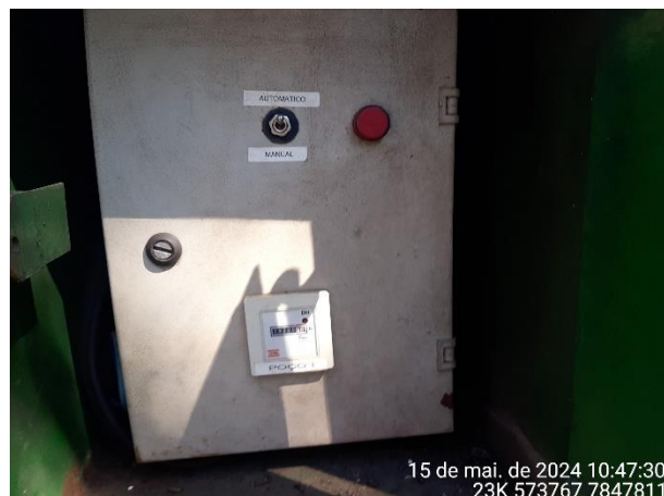
Foto 38: Horímetro do Poço 01.
