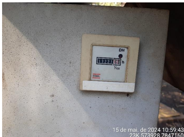
Foto 43: Horímetro do Poço 03.
