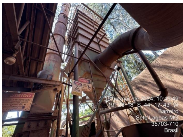
Foto 57: Filtro de despoeiramento dos finos de minério.
