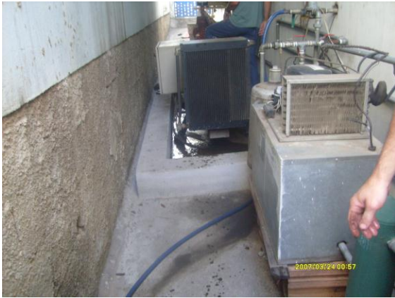
Foto 5. Compressor com bacia de contenção.
