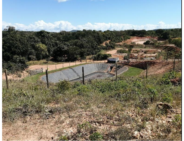
Foto 4: Lagoa de Acumulação e Bombeamento de Chorume
