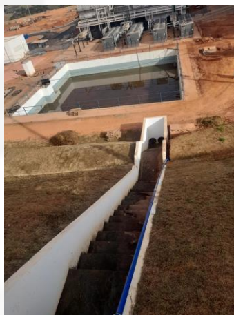
Foto 10: Reservatório de reuso
