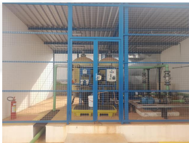
Foto 6: Estação de tratamento de água
