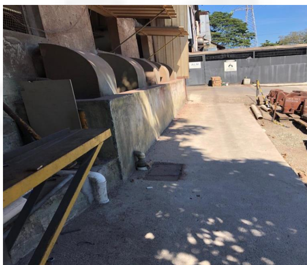
Foto 08. Cortina d'água presente no exaustor da unidade de remoção de resíduos de resinas.
