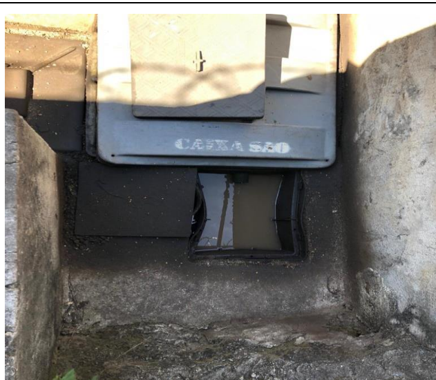
Foto 05. Saída da Caixa Separadora de Água e Óleo – CSAO.
