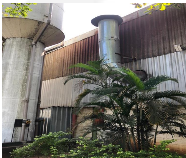
Foto 07. Chaminé de exaustão da cabine de pintura.
