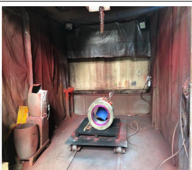
Foto 06. Uma das cabines de pintura existente. Aos fundos o lavador de gases tipo cortina d'água.
