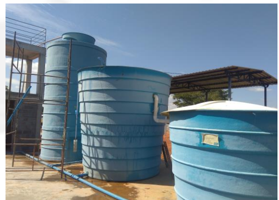
Figura 6: Parte da ETE industrial.
