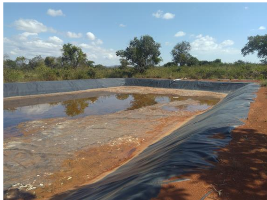
Figura 7: Lagoa de estabilização.
