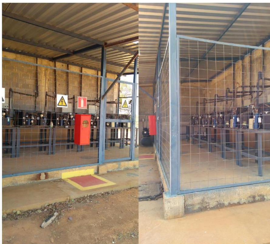
Figura 4. Local de instalação dos motores com gás freon. Fonte: Frigorífico Maísa Ltda., 2017.
