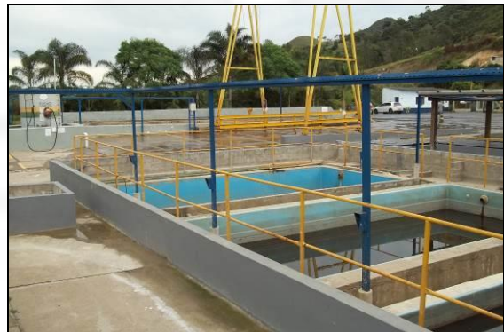
Foto 04. Parte da ETE industrial.
