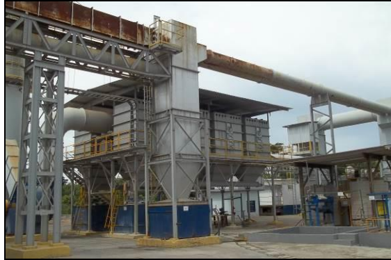
Foto 01. Tratamento de emissões atmosféricas.
