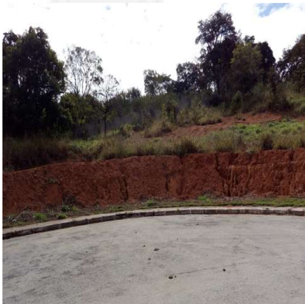
Imagem 14: Talude sem revegetação exposto
