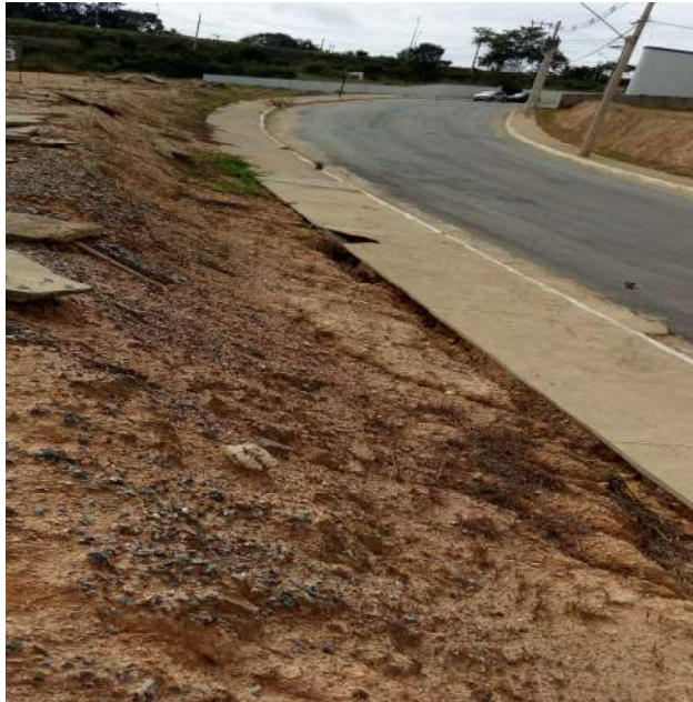
Imagem 12: Taludes sem revegetação em vias
