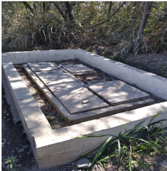
Foto 03 ETE- Fossa Séptica
