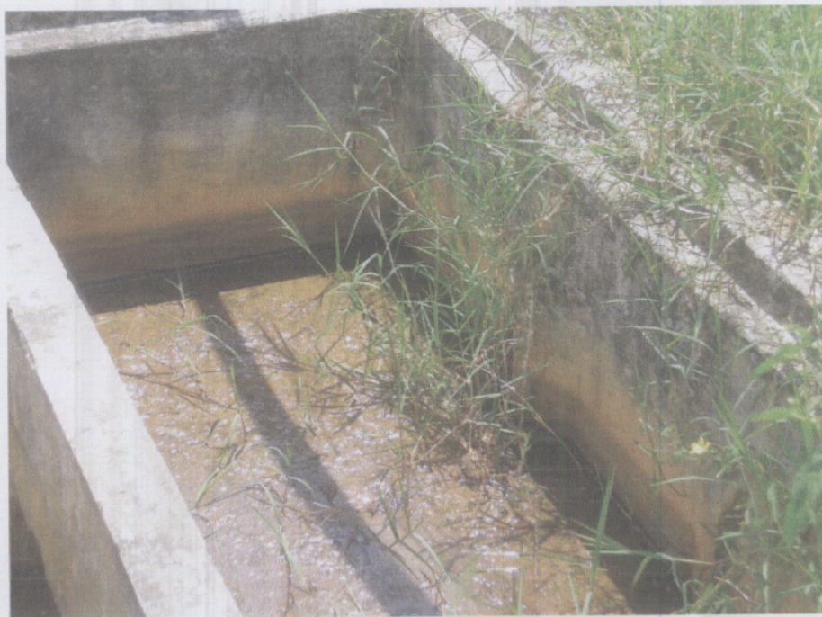
Foto 10 – Caixa coletora dos efluentes líquidos
