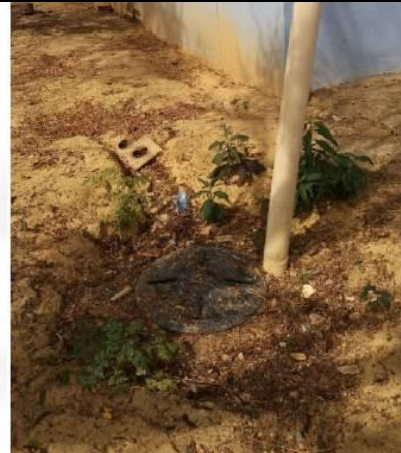
Foto 03. Sistema de tratamento do esgoto sanitário – fossa séptica.
