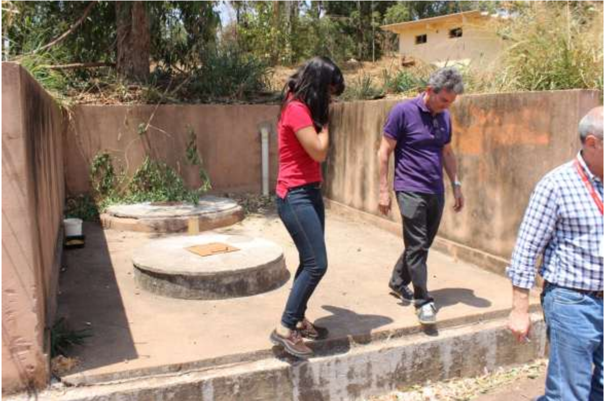
Unidades de tratamento de efluentes sanitários com tampa de metal instalada.
